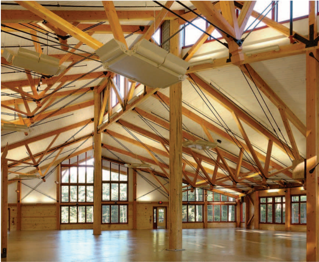
Poste y viga. Sobre la estructura se construyen el tejado, las plantas intermedias y las paredes exteriores.
